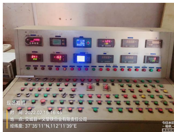
4#锰矿烘干回转窑 PLC 控制柜
