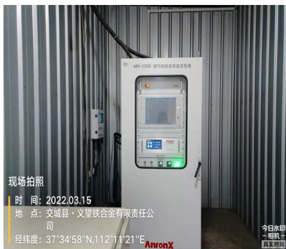
7#石灰石回转窑在线监控设备
