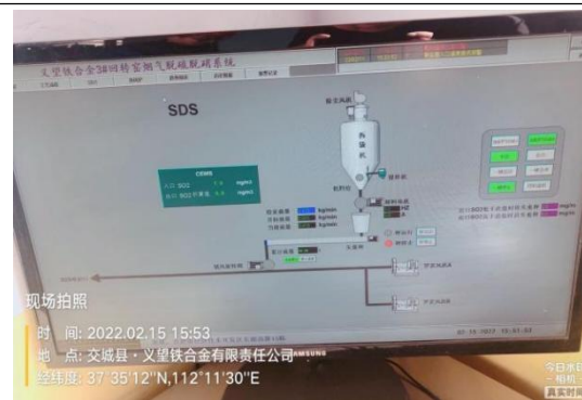
3#石灰石回转窑脱硫脱硝系统 PLC 控制系统
