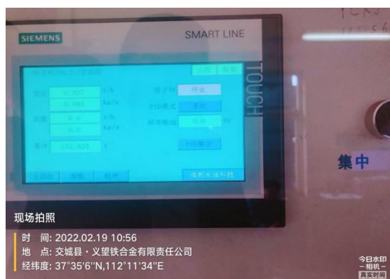
4#锰矿烘干回转窑煤粉料仓 PLC 控制系统
