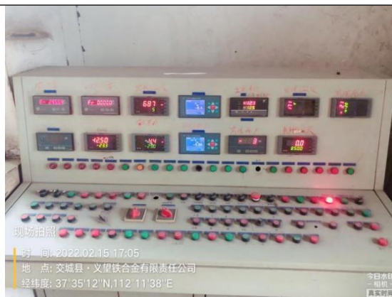
5#石灰石回转窑 PLC 控制柜
