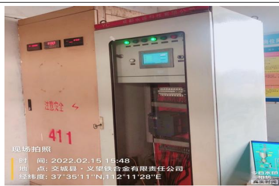
3#石灰石回转窑煤粉仓 PLC 控制柜
