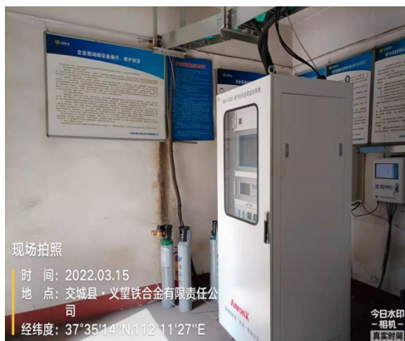
3#石灰石回转窑在线监控设备
