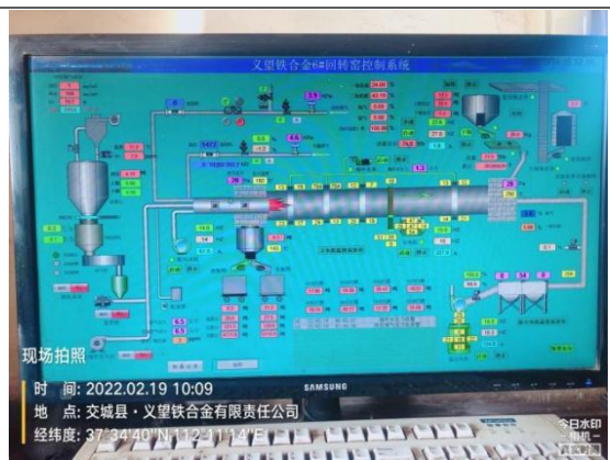
6#锰矿烘干回转窑 PLC 控制系统
