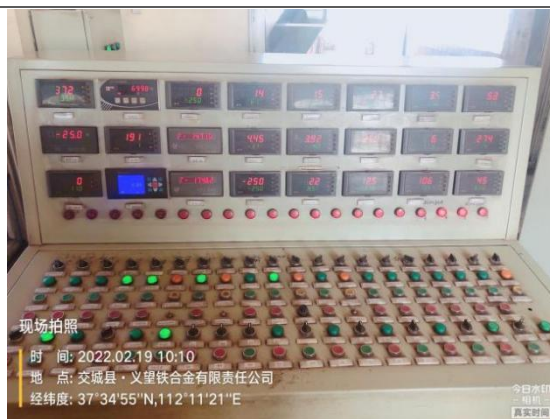
6#锰矿烘干回转窑 PLC 控制柜
