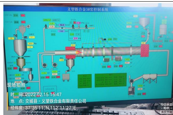
3#石灰石回转窑 PLC 控制系统
