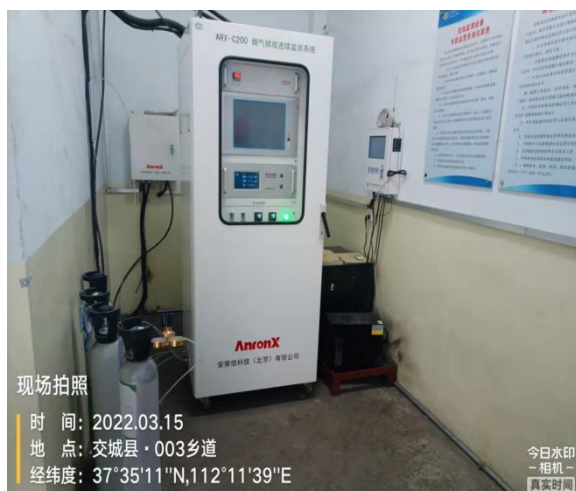
5#石灰石回转窑在线监控设备
