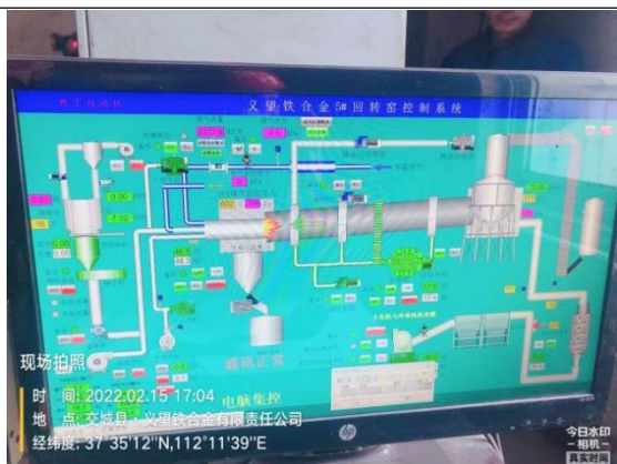
5#石灰石回转窑 PLC 控制系统
