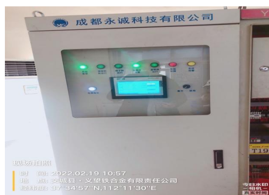
5#石灰石回转窑煤粉料仓 PLC 控制系统
