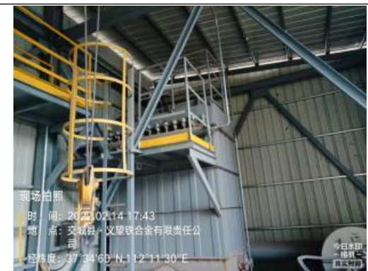
8#回转窑脱硫剂料仓及其除尘器
