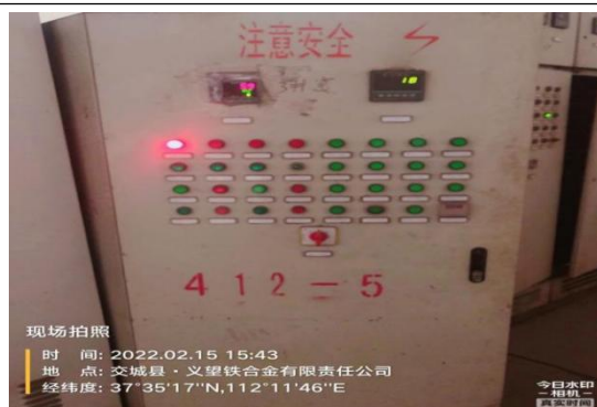
3#石灰石回转窑除尘系统 PLC 控制柜
